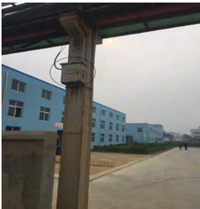
图 5.14 园区监控控制箱
