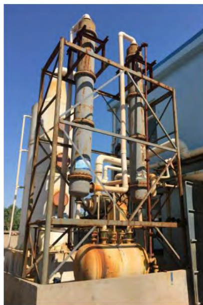
南侧两级降膜+一级碱吸附塔
