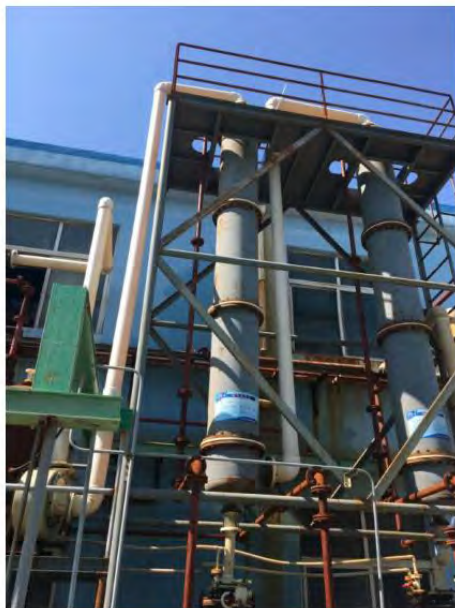
北侧两级降膜吸收塔
