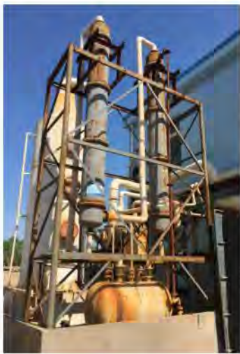
南侧两级降膜+一级碱吸附塔
