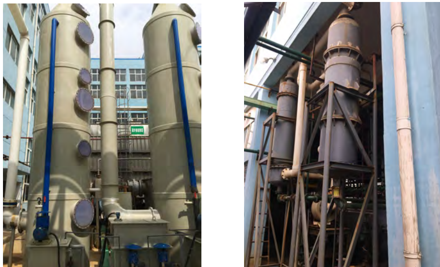
图 5.4 六车间活性炭纤维装置与六车间三级碱吸收装置
