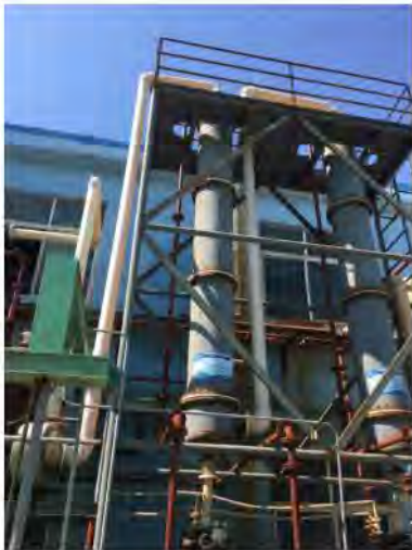
北侧两级降膜吸收塔
